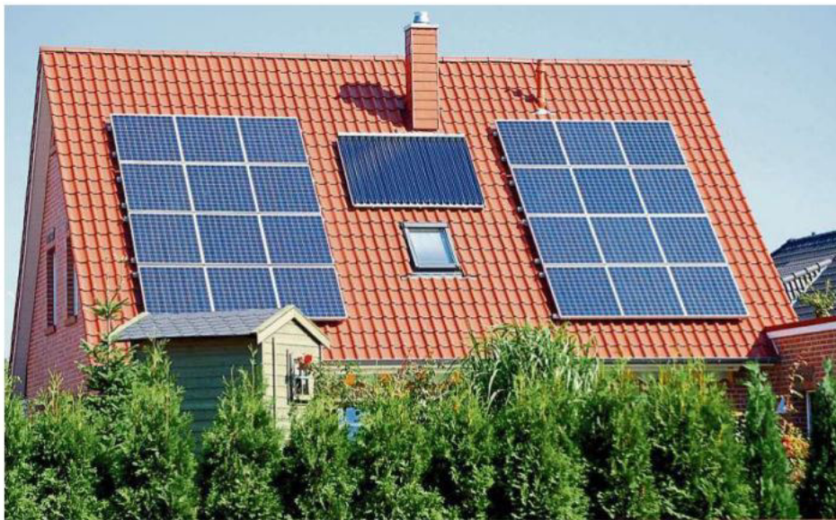
Photovoltaikanlagen auf dem Dach sind nur ein Weg, sich für das Klima und die Umwelt einzusetzen. Die „Grüne Hausnummer Plus“ im Kreis honoriert das seit 2016.
